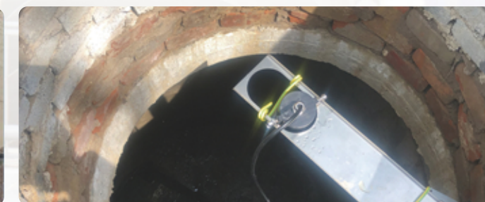
城市管网窰井水位监测
